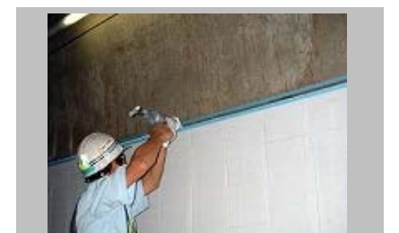
8 タイル天端部・側端部にシーリングを施します。（マスキング養生⇒プライマー塗布⇒シーリング材充填⇒仕上げ処理）
